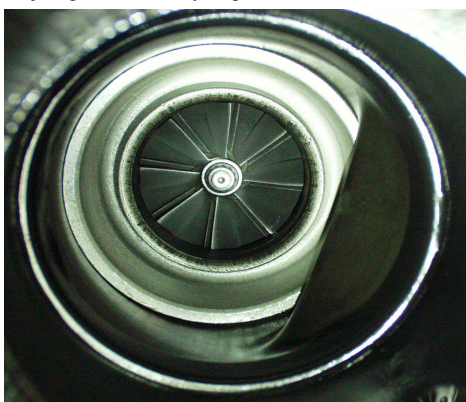
f) silnik dwucylindrowy Detroit Diesel 16V149TI – deformację łącznika gumowego w kanale dolotu powietrza do sprężarki układu turbodoładowania
