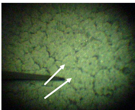
IX st. sprężarki silnika LM-2500 – pęknięcia uszczelnienia wieńca wirnikowego w kształcie „pajęczyny”
