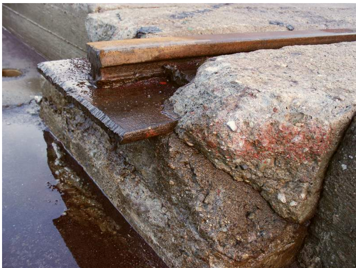
Fot. 3. Warstwy betonu powstałe wskutek napraw
